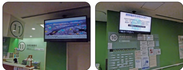
待ち時間を有効に活用できる電子看板を設置
